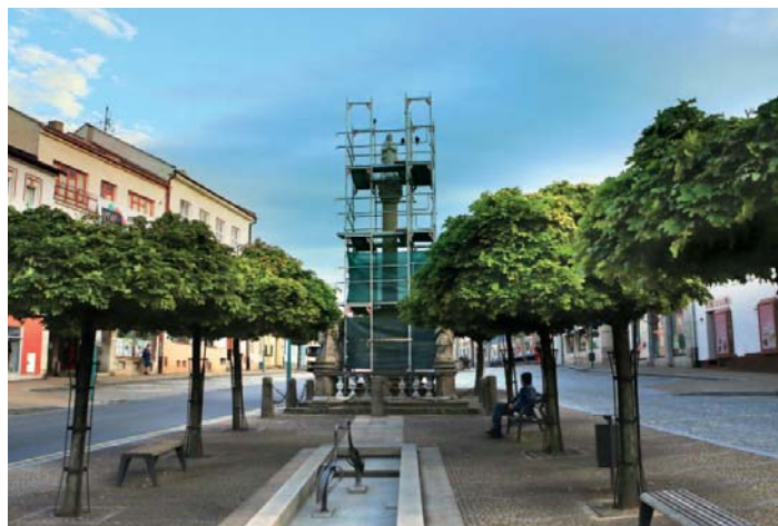
Restaurování Mariánského sloupu na náměstí v létě roku 2019. V potoce jsou umístěny kovové prvky od uměleckého mistra kováře Milana Beneše.
